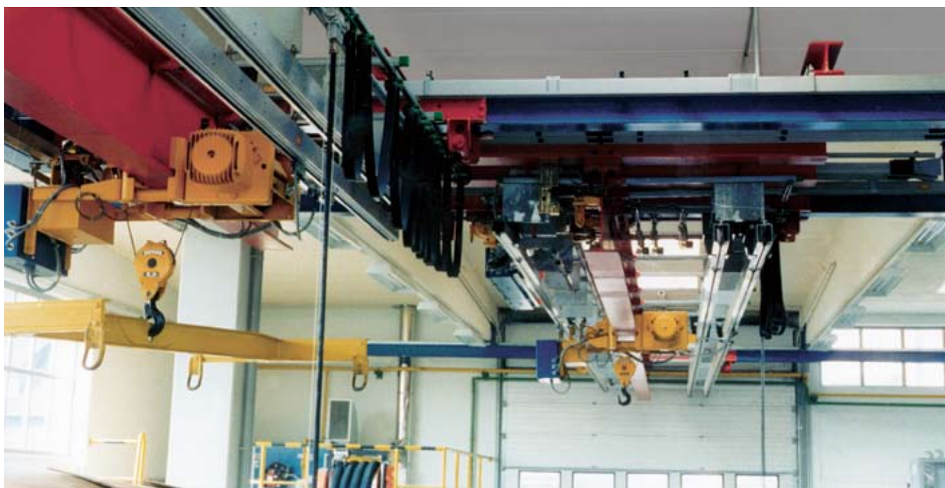
● Безопасный троллейный шинопровод на мостовом кране
